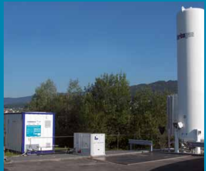
WEDECO Ozonanlage auf der Kläranlage Wüeri in Regensdorf, Schweiz
